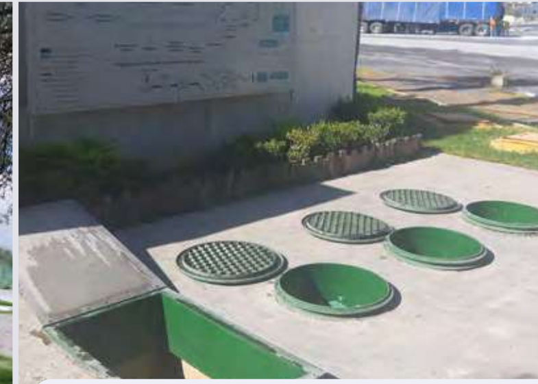
Sistema de tratamiento de agua residual, Planta Monterrey
