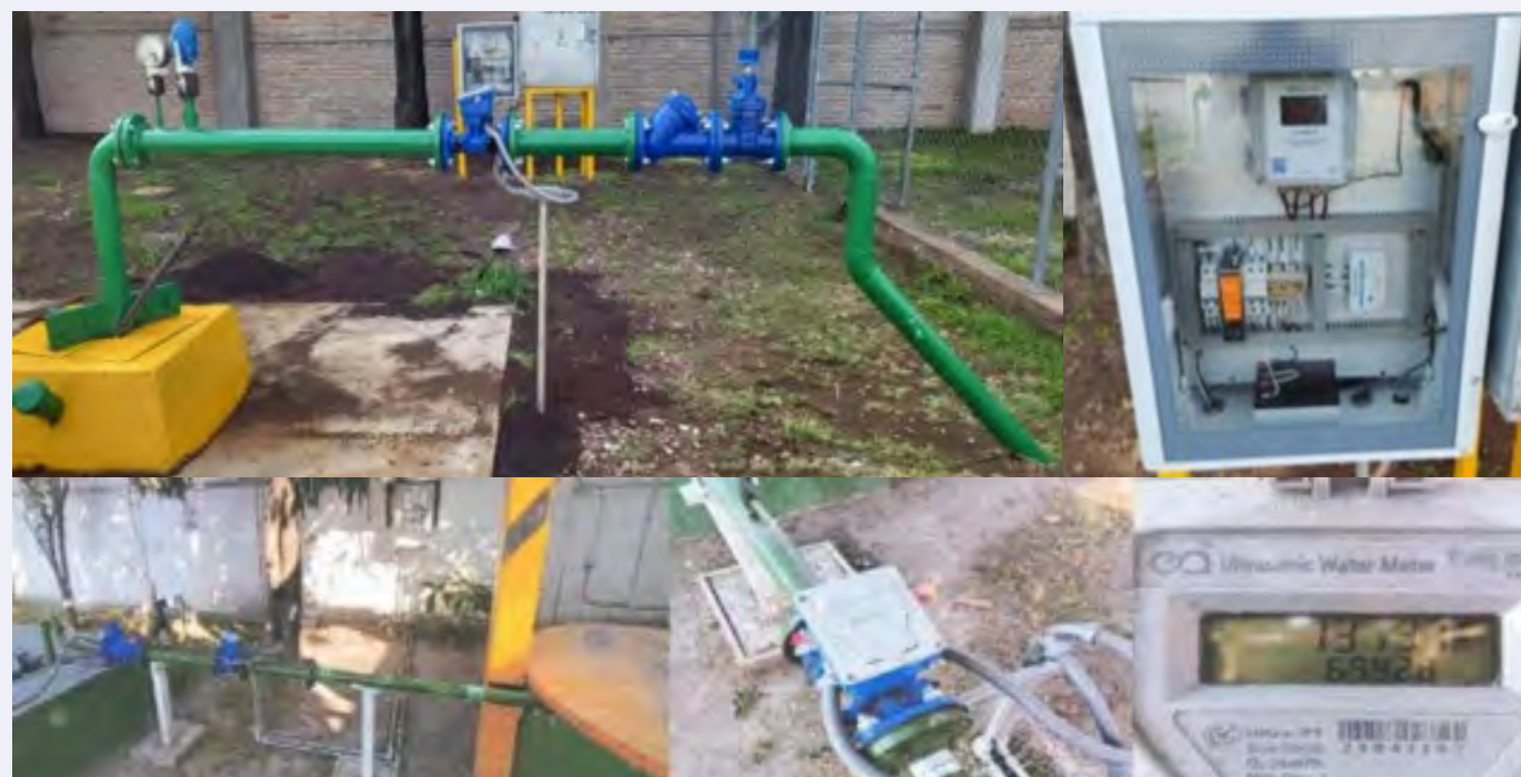
Caudalímetro con sistema de medición del gasto y transmisión por telemetría Planta Aguascalientes.
